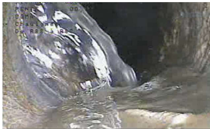
Exemple de réseau non étanche avec entrée d'eaux claires, pluviales ou de nappe.
