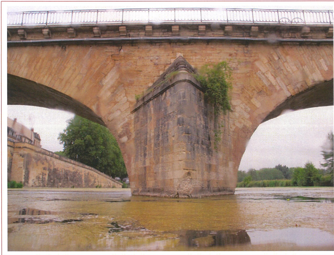
Avant bec Pile 1 Végétation parasite au niveau du couronnement -Photo 6-
