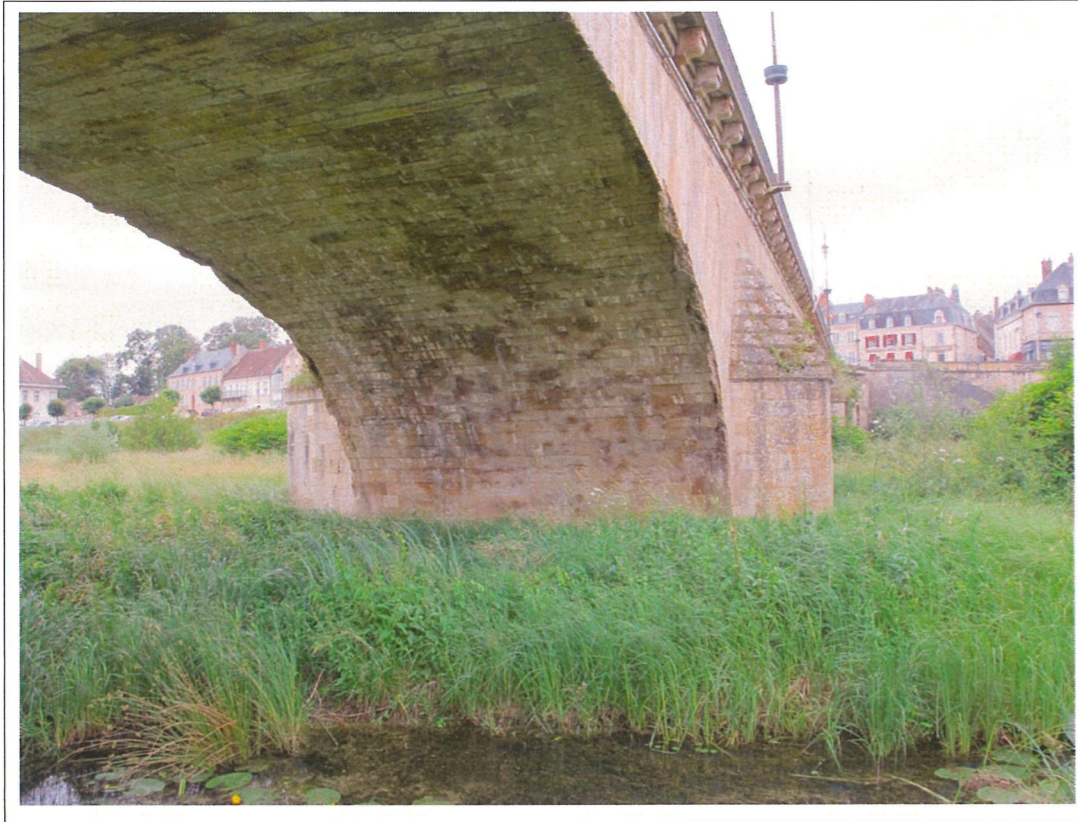
Face droite Pile 3 -Photo 22-
