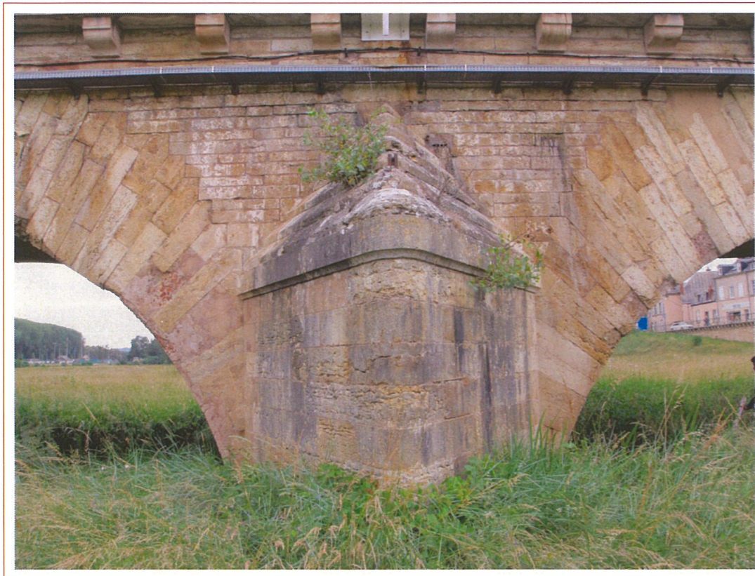
Avant bec Pile 8 Erosion et végétation parasite -Photo 50-
