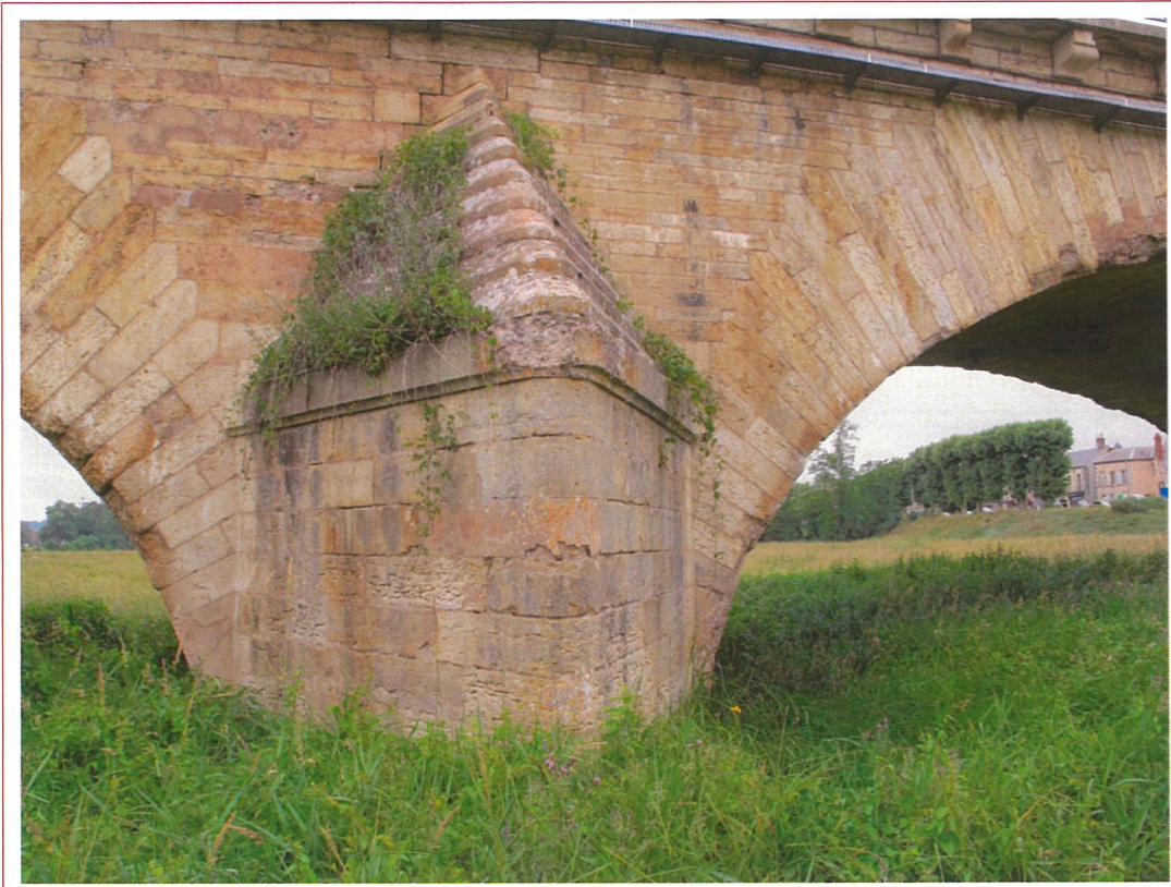
Avant bec Pile 5 Erosion -Photo 31-
