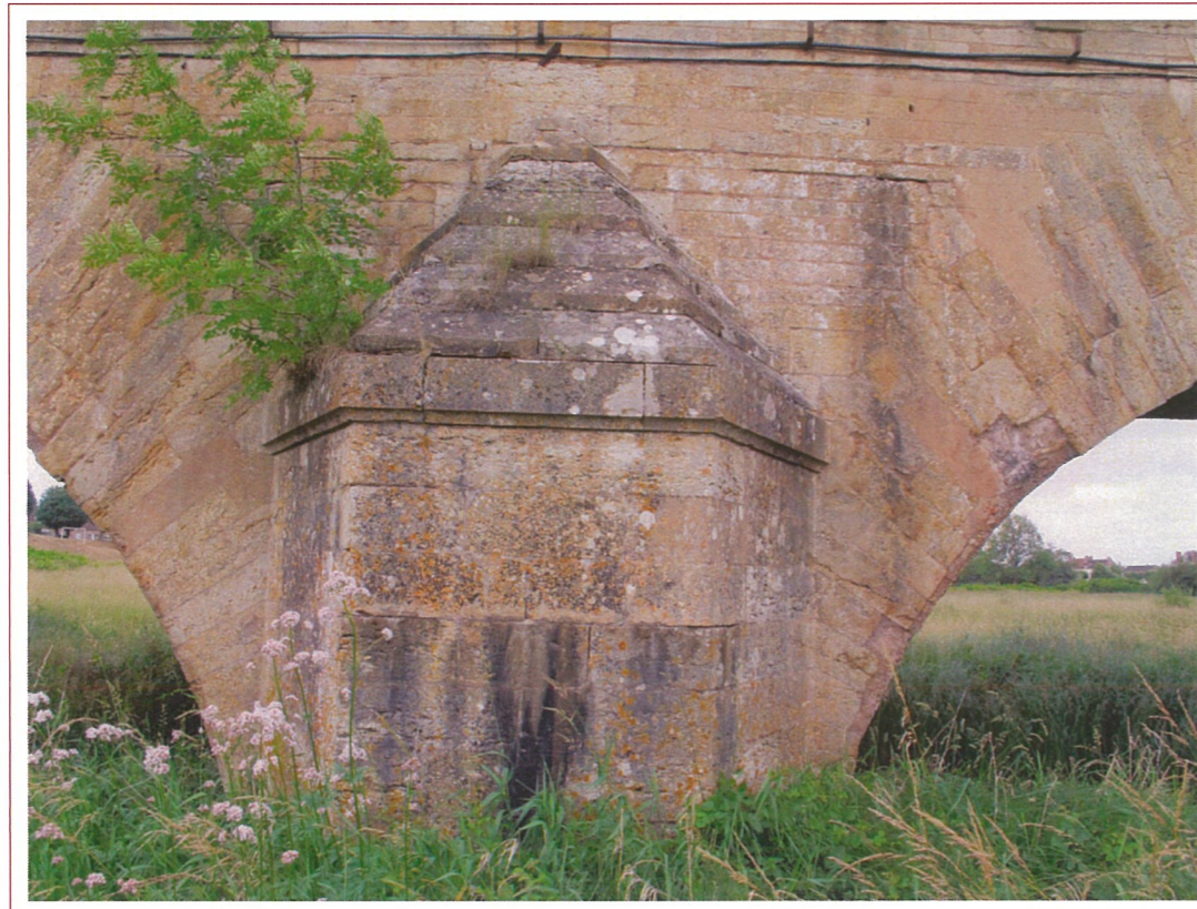
Arrière bec Pile 8 Végétation parasite sur le couronnement -Photo 54-
