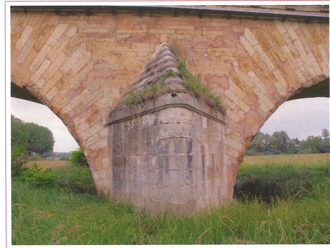
Face droite Pile 3 (Amont) Erosion du bandeau -Photo 23-
