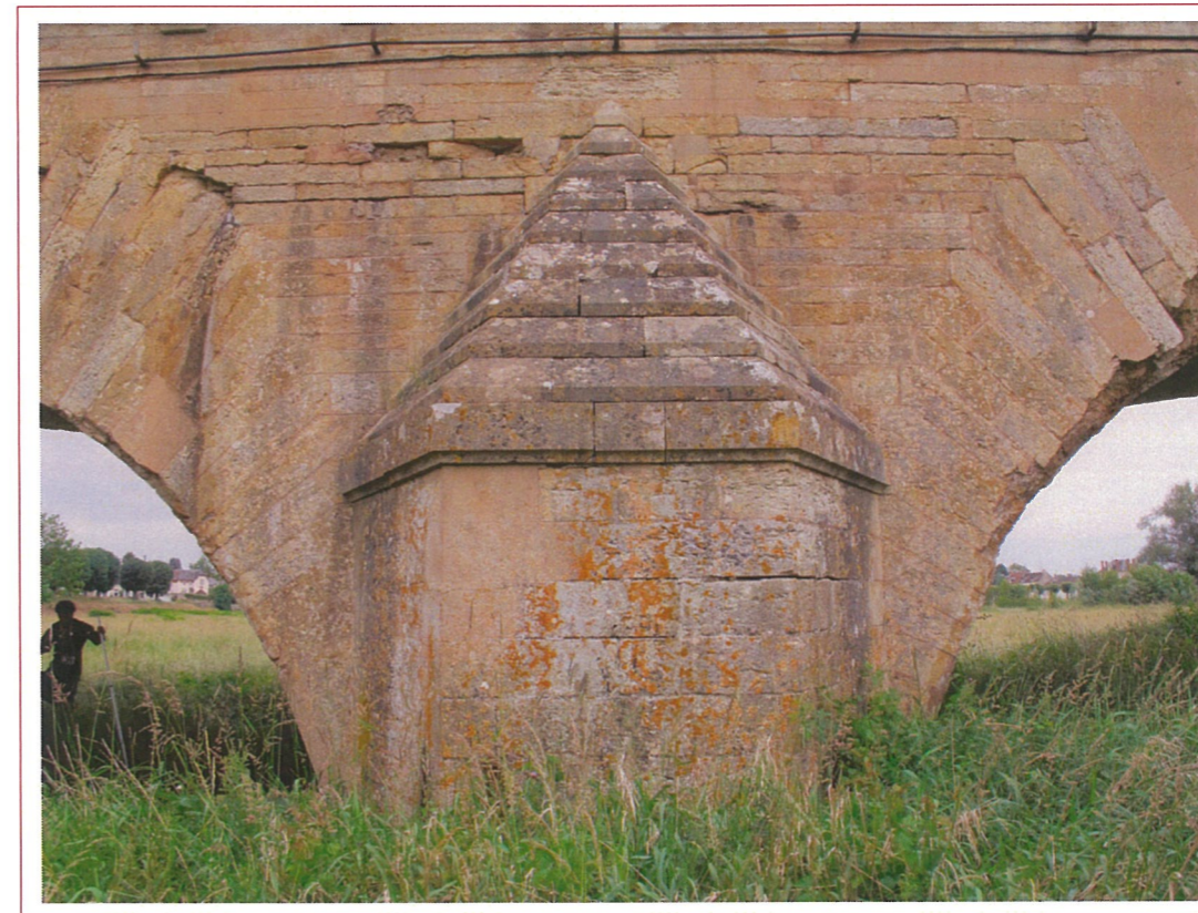
Arrière bec Pile 6 Epaufures du tympan -Photo 41-
