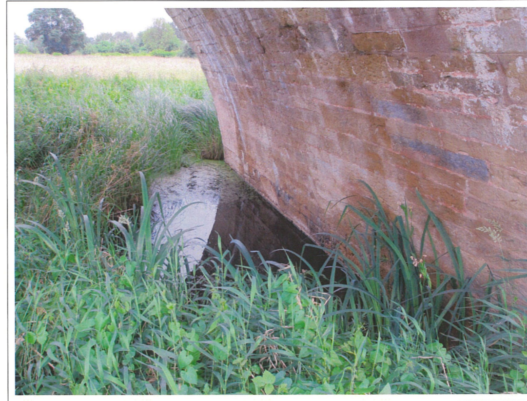
Face droite Pile 5 -Photo 36-
