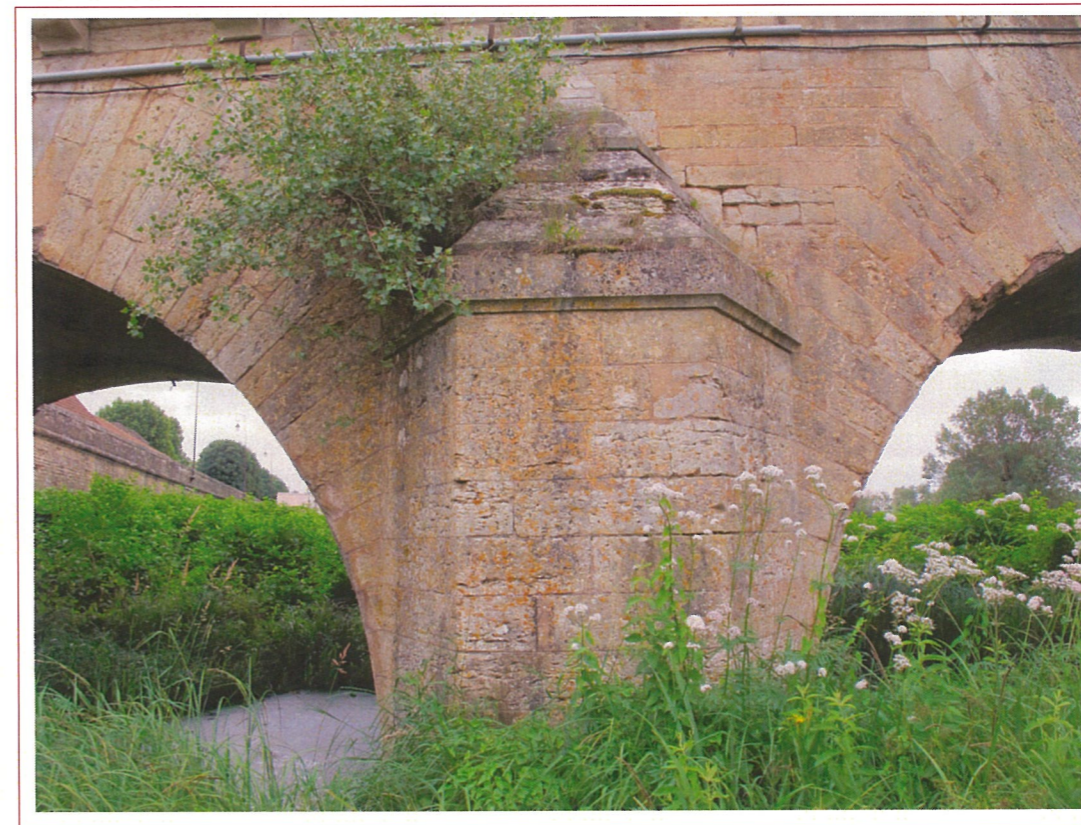
Arrière bec Pile 10 Végétation parasite sur le couronnement -Photo 65-
