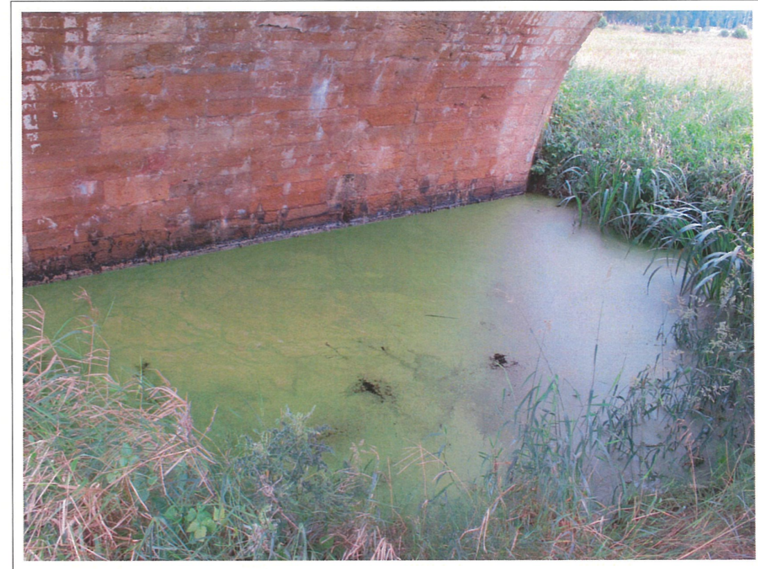
Face droite Pile 6 -Photo 43-
