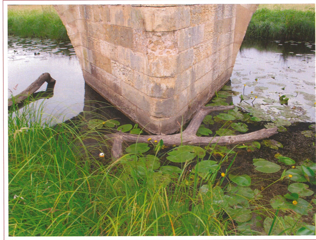
Avant bec Pile 4 Tronc d'arbre -Photo 25-
