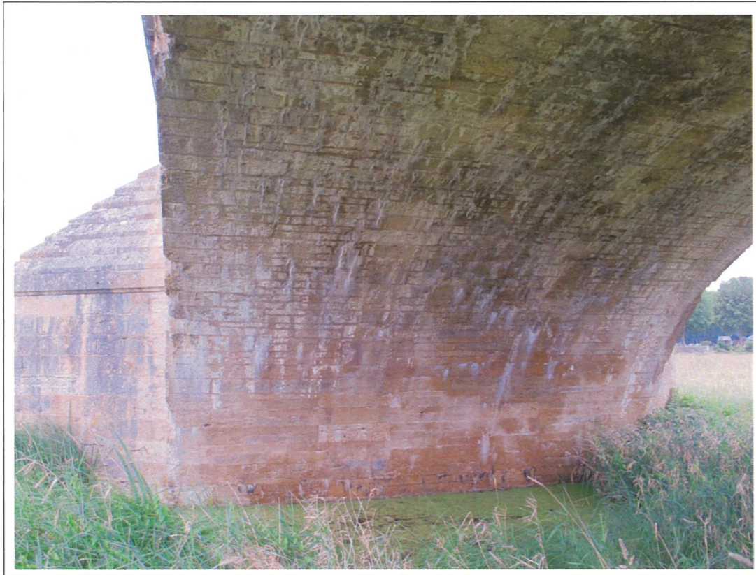
Face droite Pile 7 -Photo 48-
