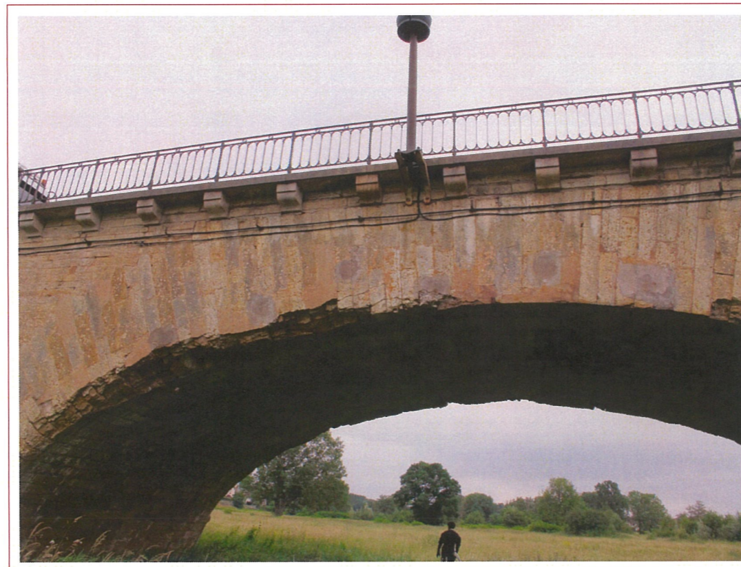
Tympan aval Epaufures du bandeau -Photo 30-
