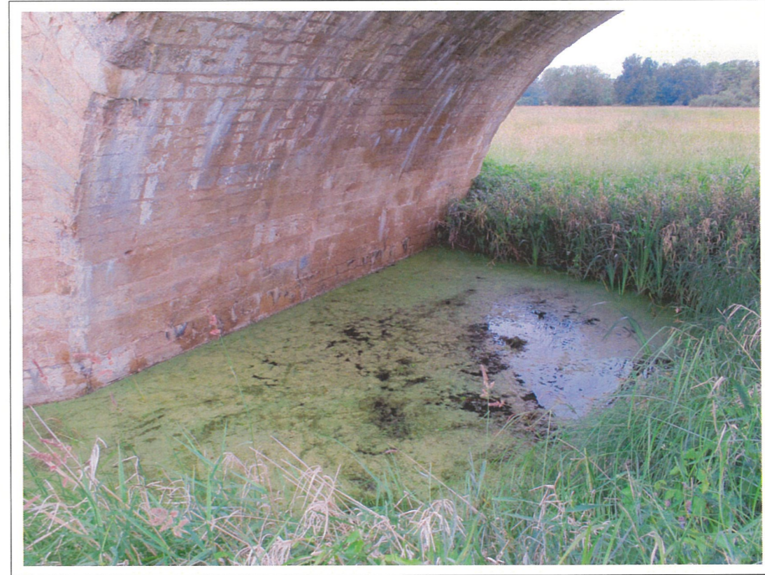
Face droite Pile 7 -Photo 49-
