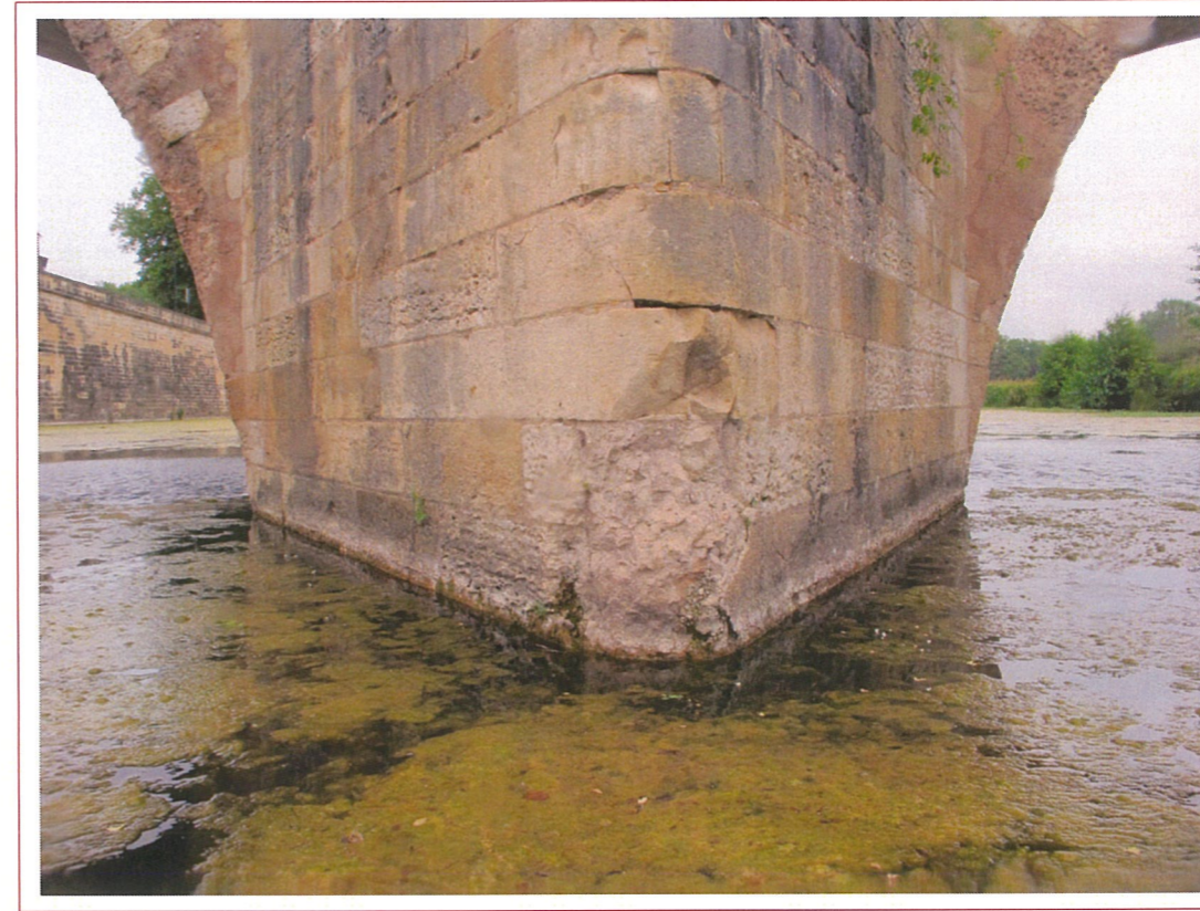
Avant bec Pile 1 Epaufrement et érosion -Photo 7-
