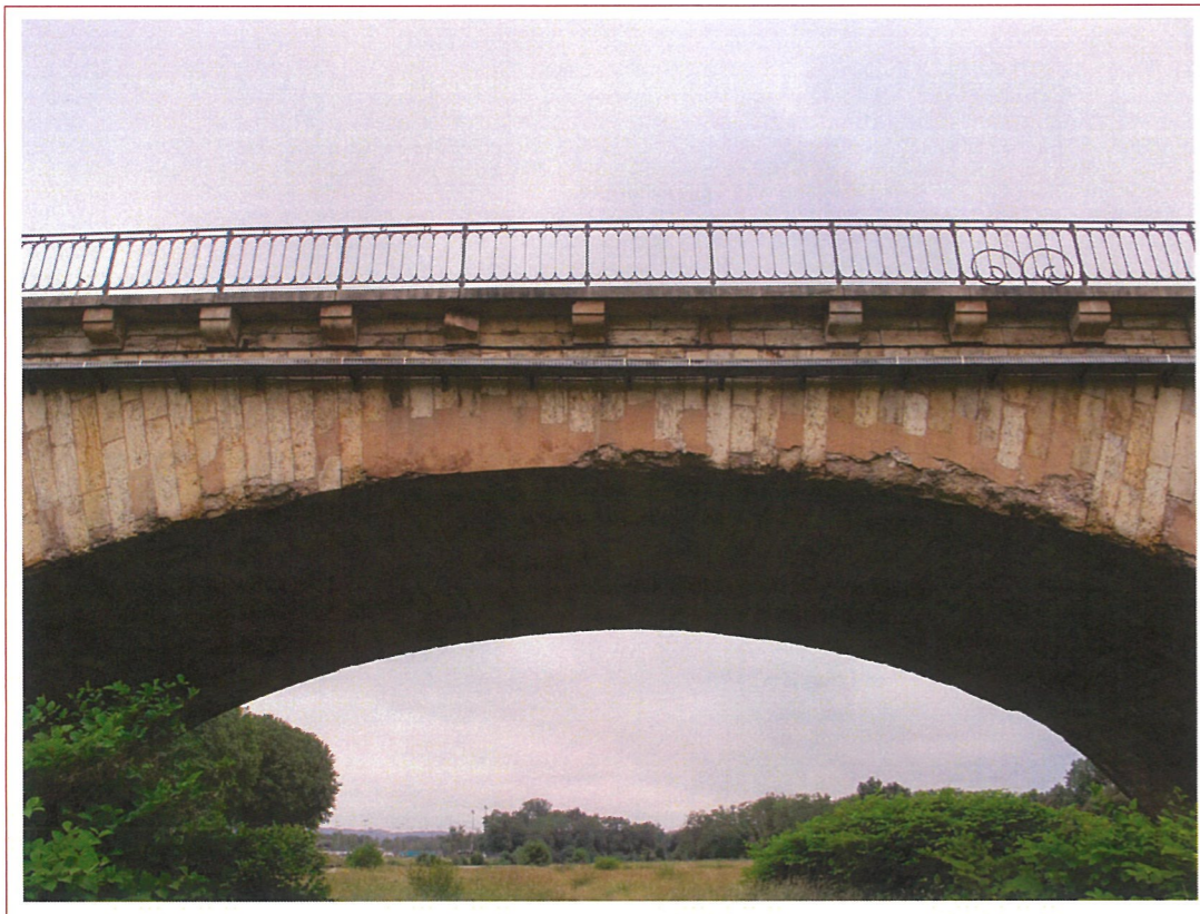
Tympan amont Passe 3 Erosion du bandeau -Photo 18-
