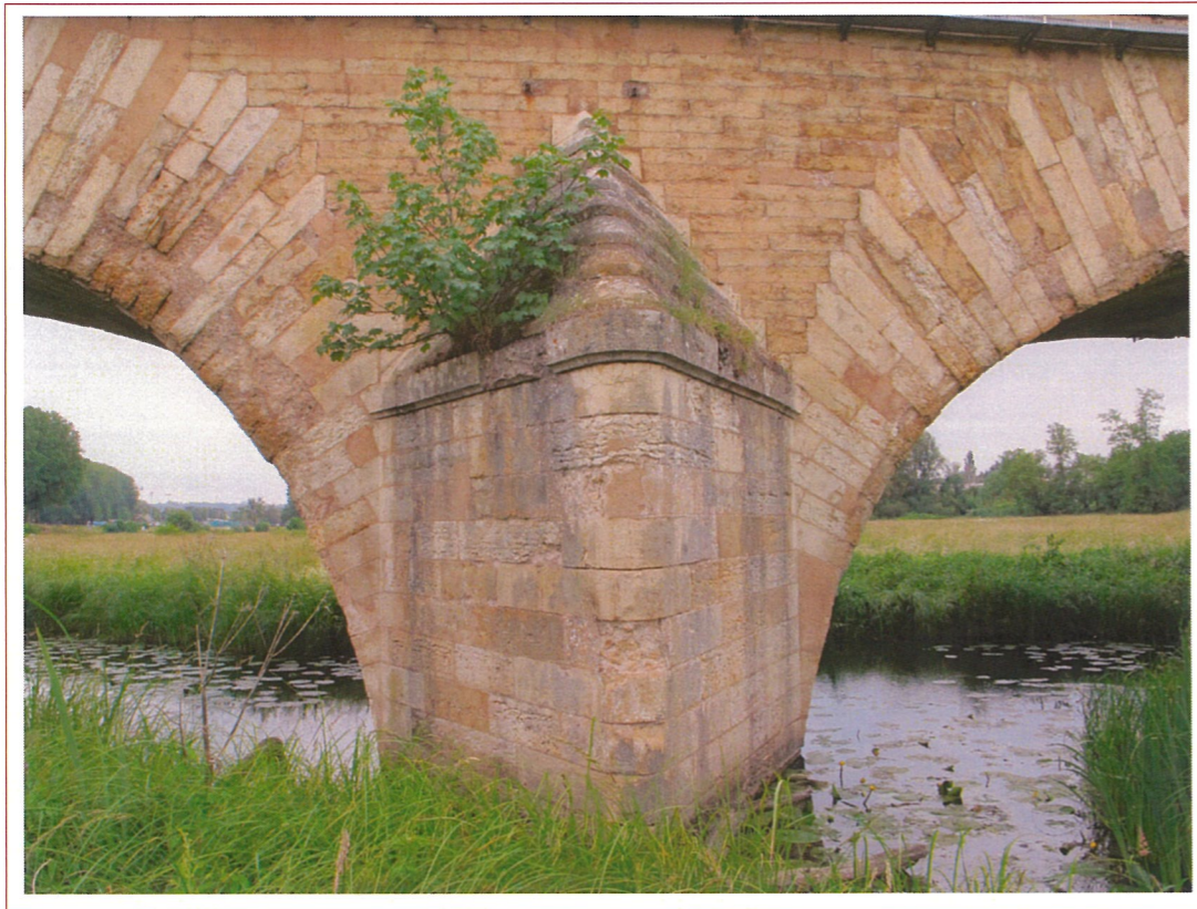
Avant bec Pile 4 Erosion ; Végétation parasite sur le couronnement -Photo 24-
