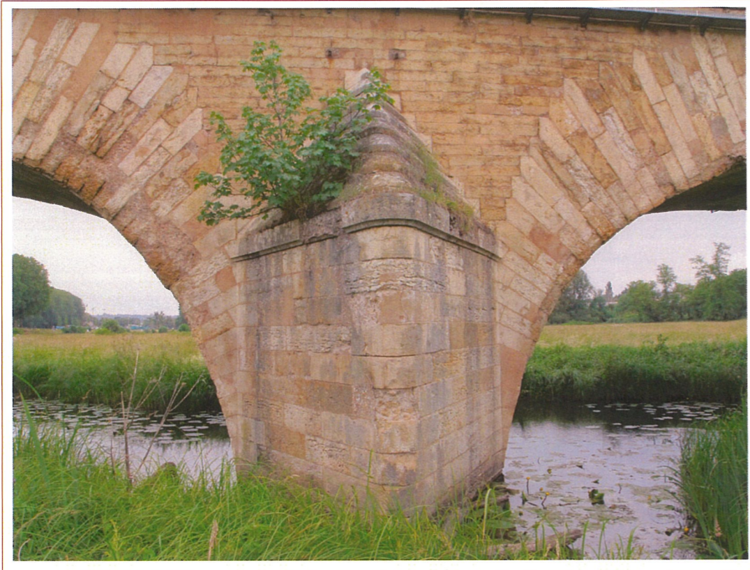
Avant bec Pile 4 Erosion ; Végétation parasite sur le couronnement -Photo 24-
