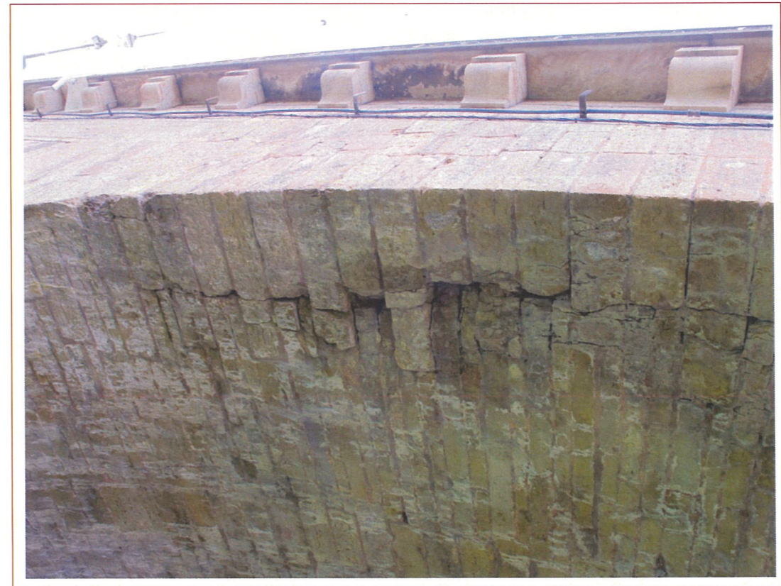
Vue de la voûte en aval de la passe 8 Fracture annulaire et érosion -Photo 53-
