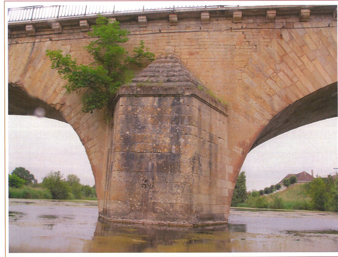
Arrière bec Pile 1 Végétation parasite sur le couronnement -Photo 11-
