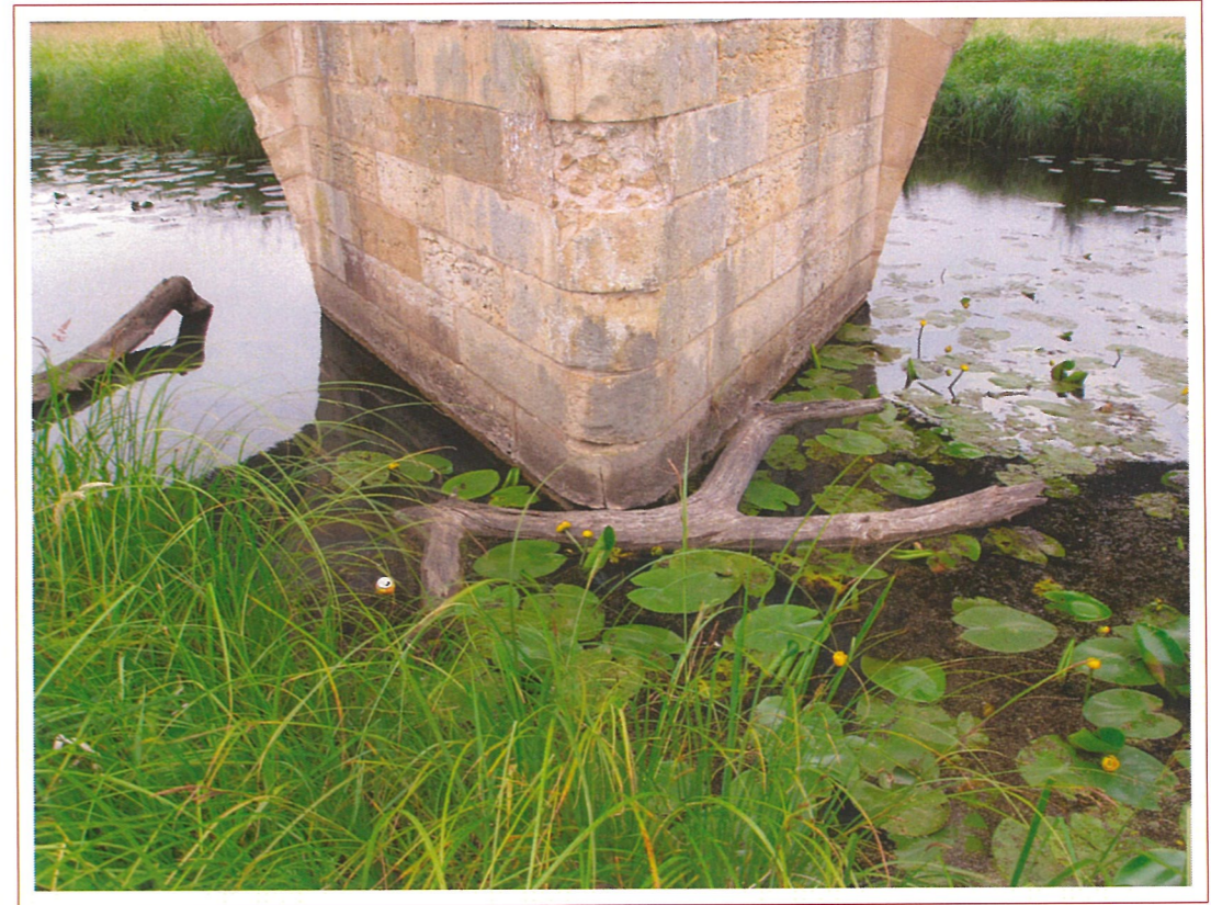
Avant bec Pile 4 Tronc d'arbre -Photo 25-
