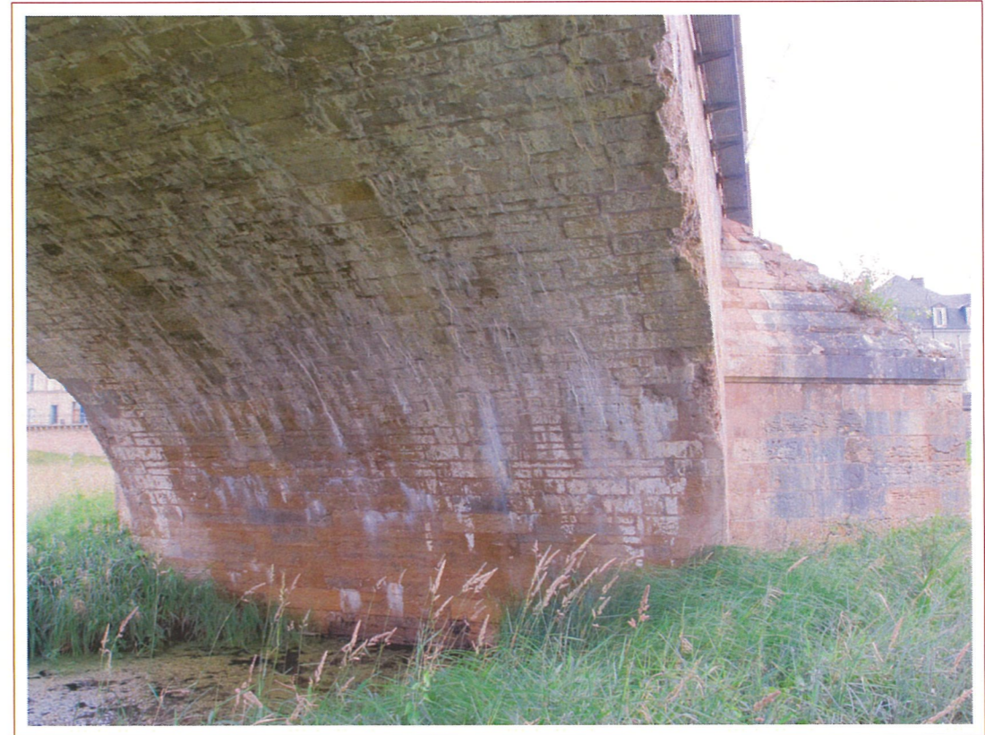
Face gauche Pile 8 Erosion du bandeau amont -Photo 51-
