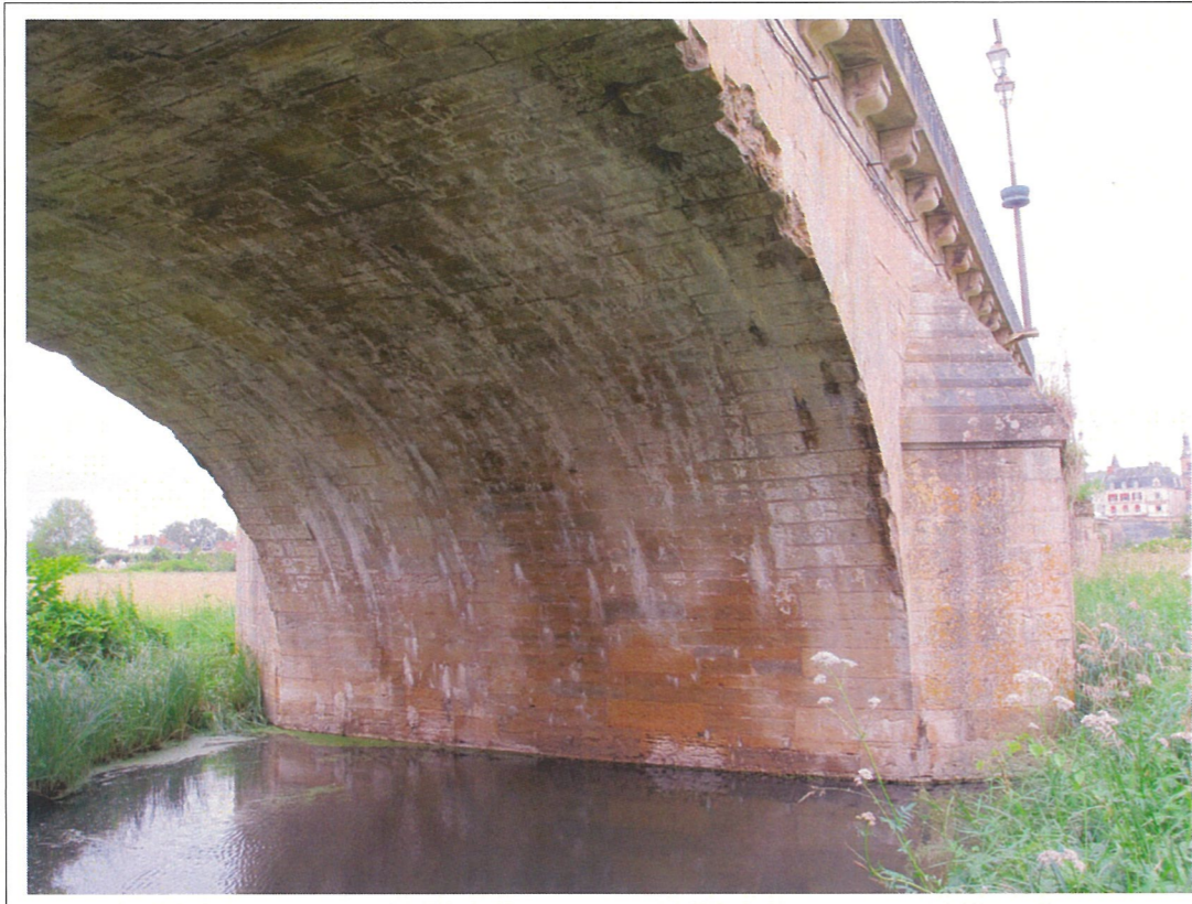
Face droite Pile 9 -Photo 60-
