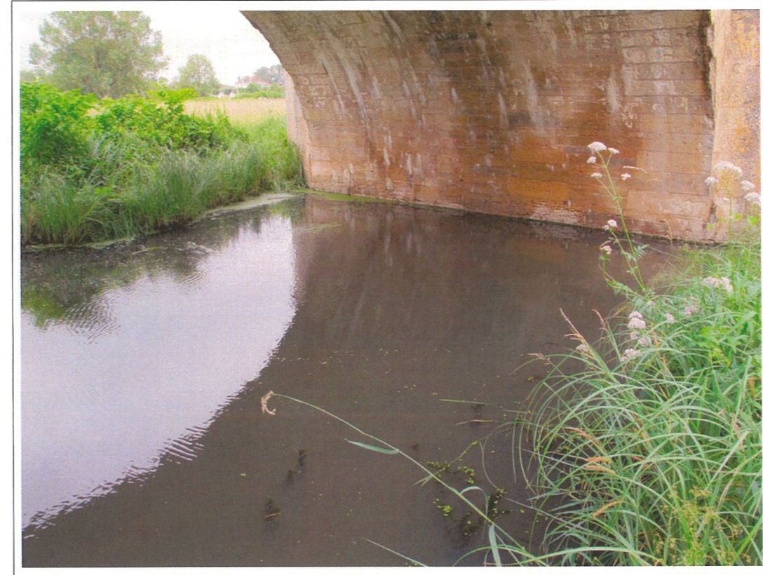
Face droite Pile 9 -Photo 61-
