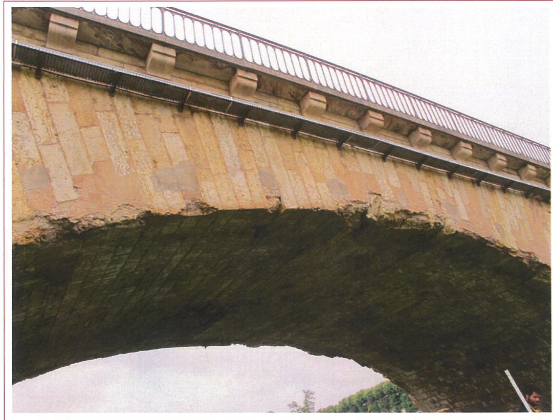
Tympan amont passe 5 Epaufures du bandeau -Photo 28-
