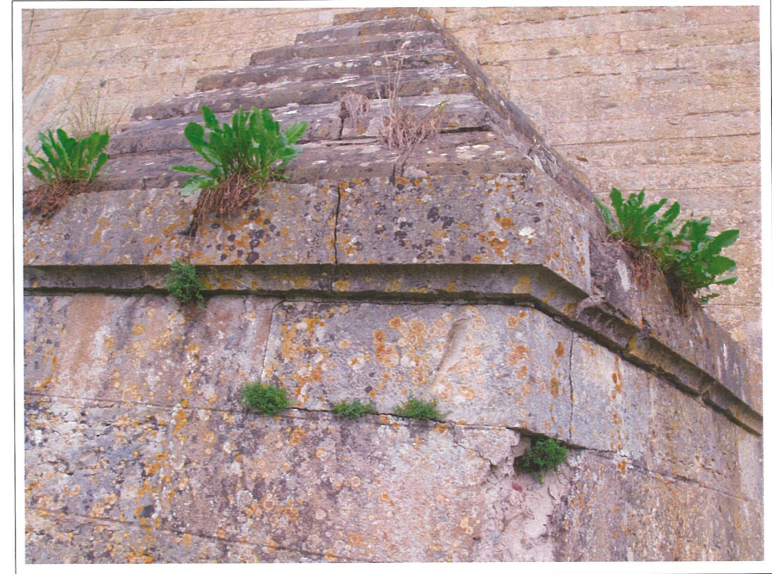
Arrière bec Pile 4 Epaufrure -Photo 27-
