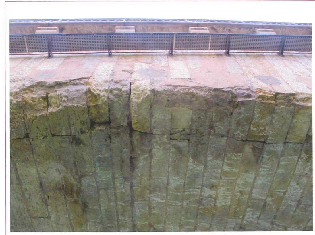
Fracture annulaire au niveau du bandeau amont -Photo 29-
