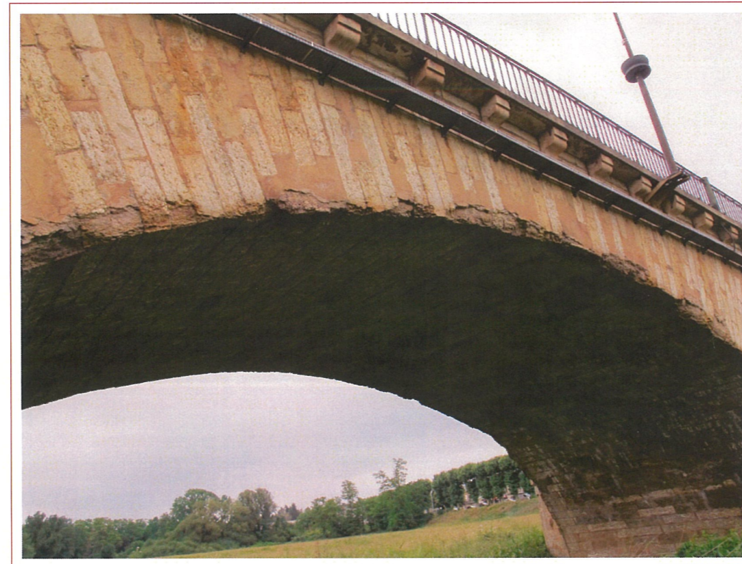
Tympan amont en passe 4 Erosion du bandeau -Photo 24-
