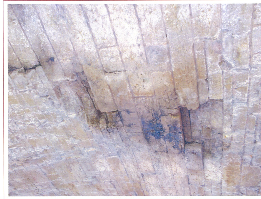
Intrados en passe 11 Pierres manquantes -Photo 67-
