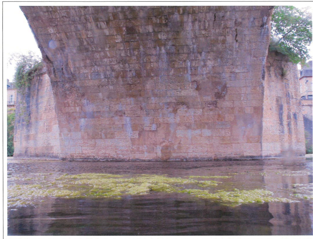
Face droite Pile 1 -Photo 12-
