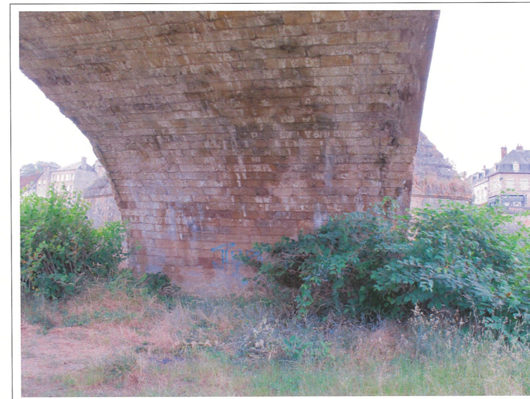
Face droite Pile 2 -Photo 17-
