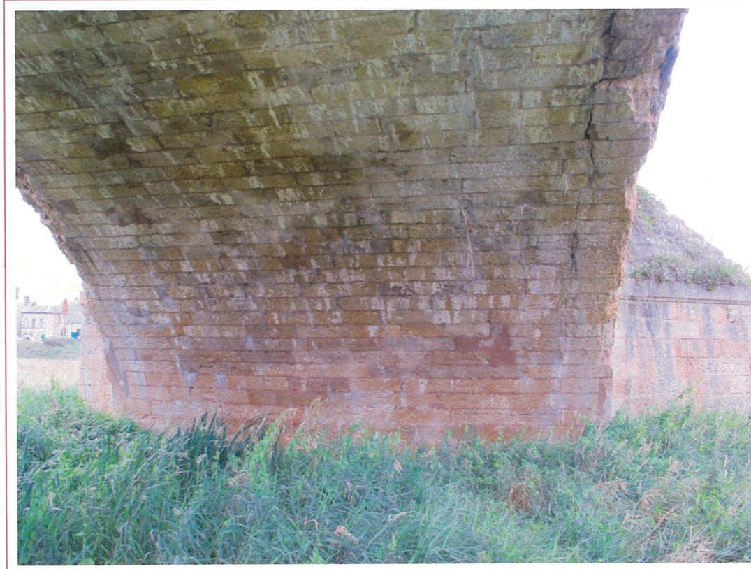
Face gauche Pile 5 Fracture annulaire au niveau du bandeau amont -Photo 32-
