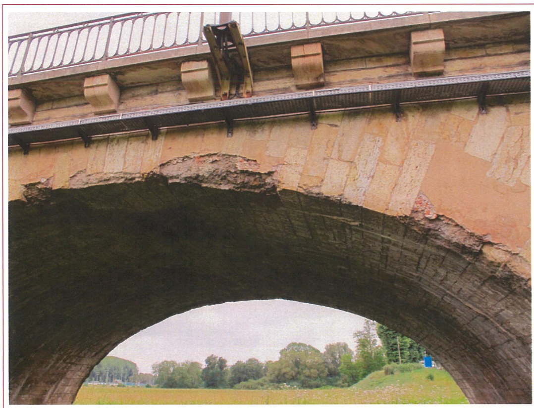
Tympan aval de la passe 11 Epaufures du bandeaux -Photo 64-
