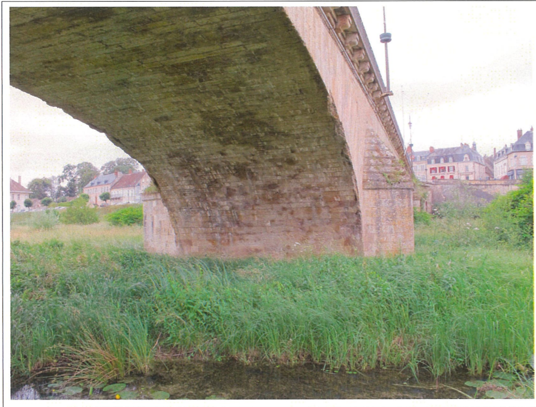
Face droite Pile 3 -Photo 22-
