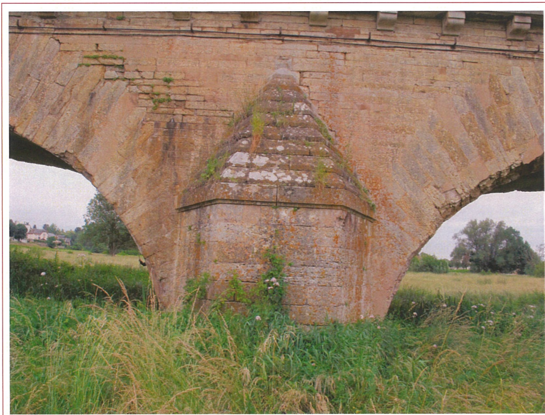
Arrière bec Pile 5 Epaufures et disjointoiements -Photo 33-
