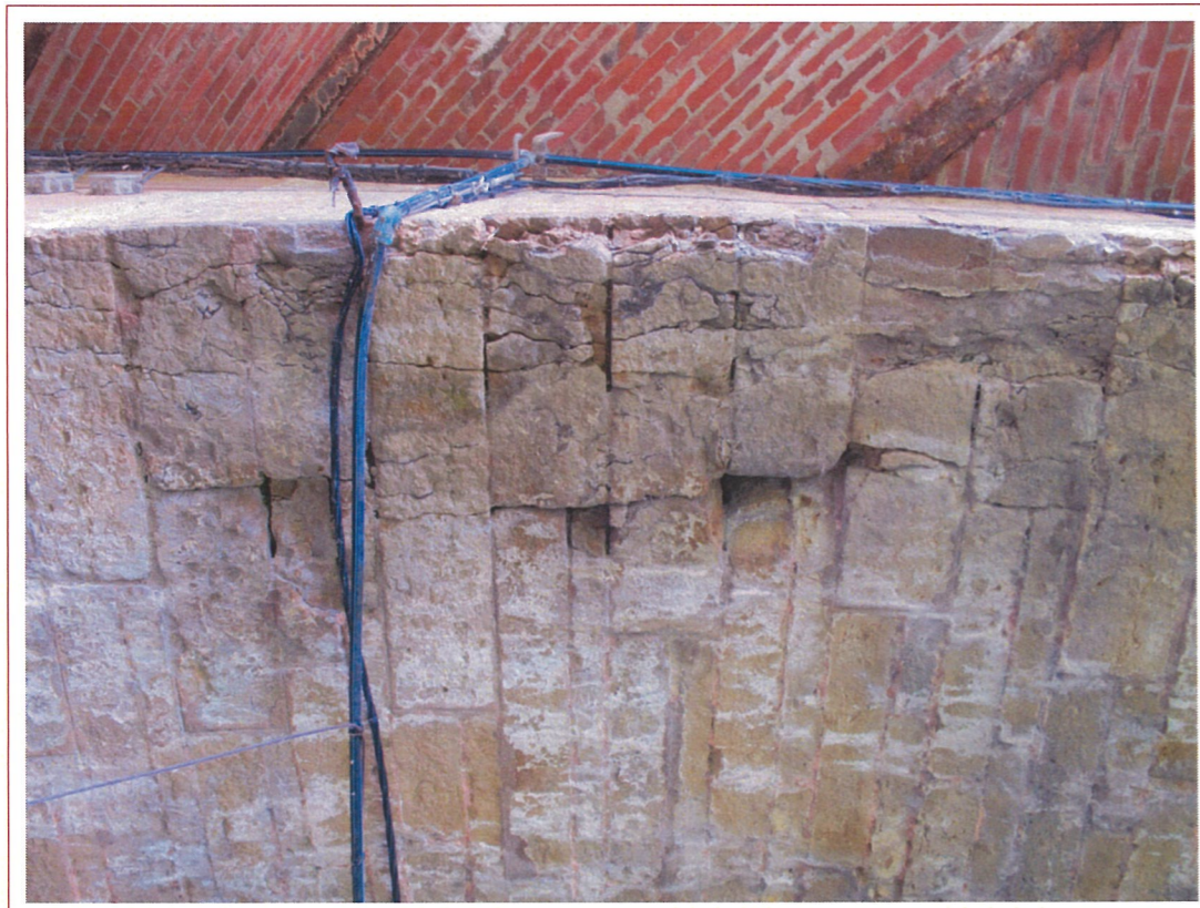
Bandeau aval en passe 11 Erosion et fissures -Photo 68-
