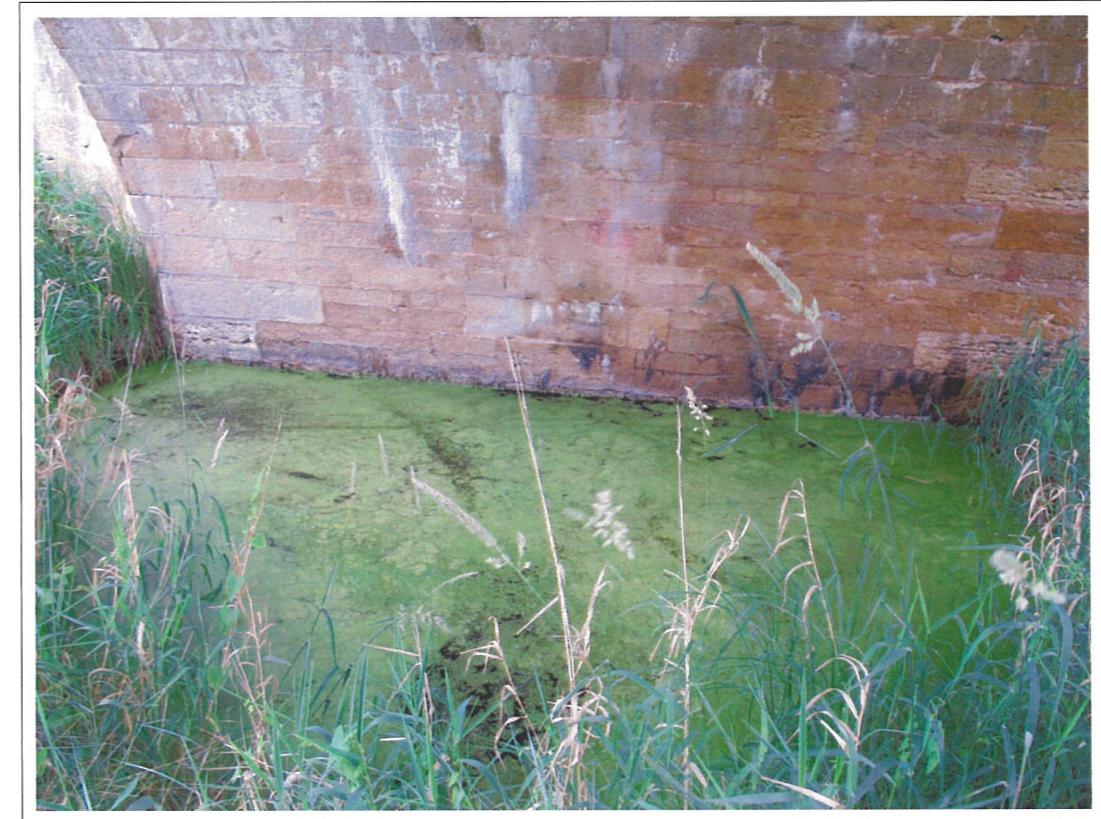
Face droite Pile 8 -Photo 55-
