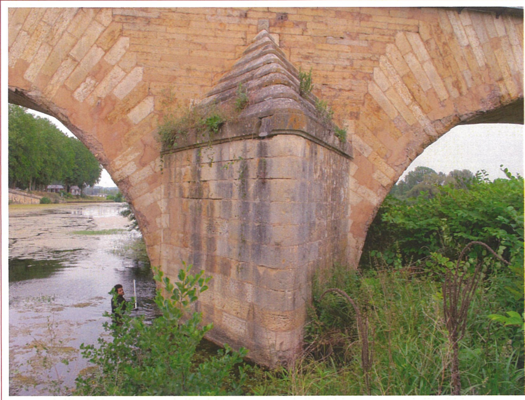
Avant bec Pile 2 Disjointement et pierre de couronnement éclatée -Photo 14-
