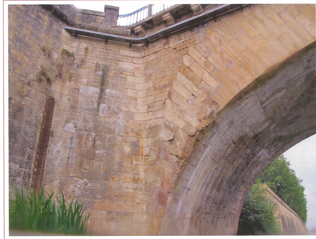
Mur retour amont de la culée rive gauche Epaufrure -Photo 3-
