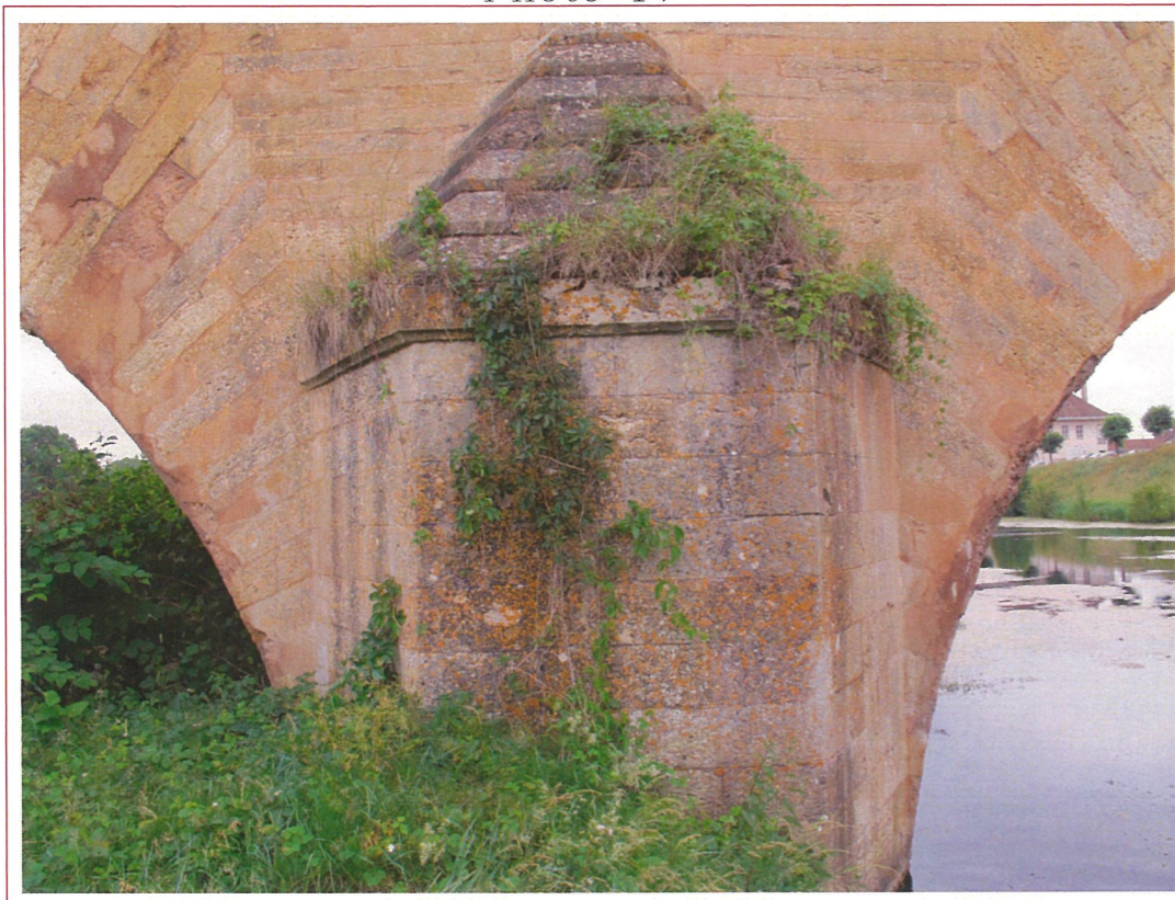
Arrière bec pile 2 Végétation parasite -Photo 16-
