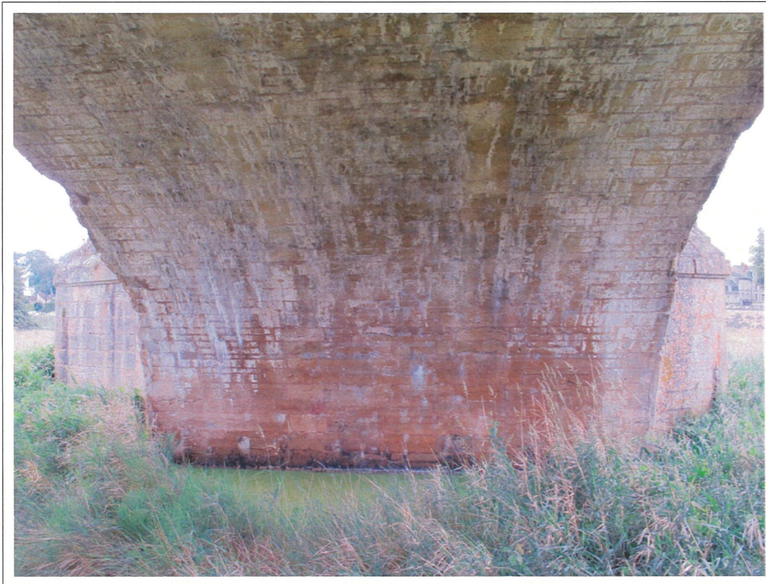
Face droite Pile 6 -Photo 42-
